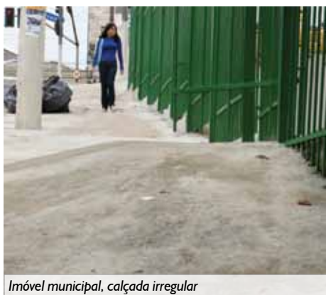
Imóvel municipal, calçada irregular
